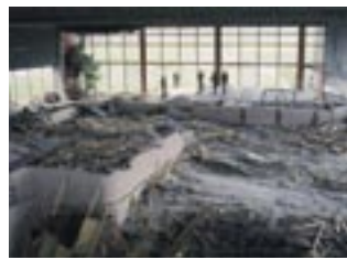
1985 brach die Betonhängendecke eines Hallenbades im schweizerischen Uster. Die Aufhängungen der Decke aus nichtrostendem Stahl zeigten rein äußerlich keinerlei Mängel, waren jedoch innerlich teilweise vollkommen durch Spannungsrissskorrosion zerstört.
